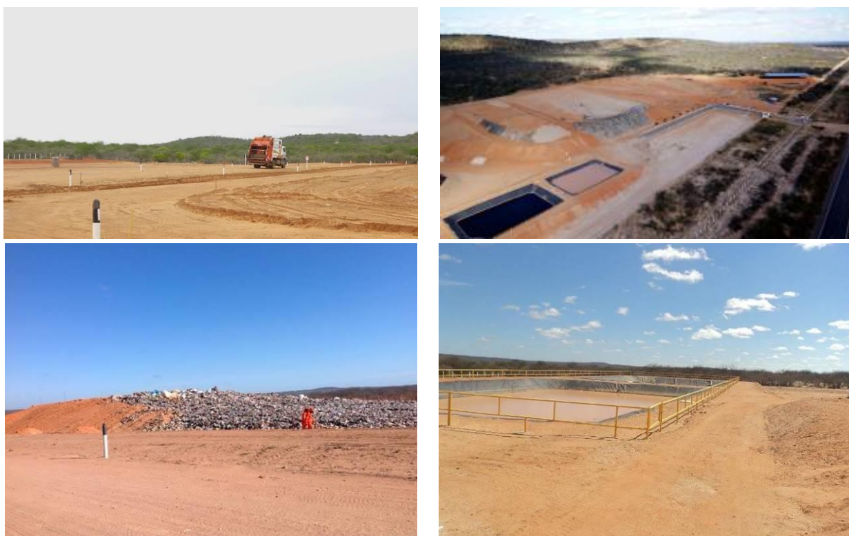
Fotos 39 a 42: Operação da Nova Área de Disposição Final. (Fonte: CTR Petrolina)
